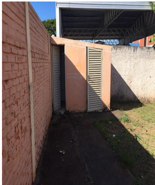
Foto 06: Demolição de alvenaria e laje do depósito, e abertura de portão para acesso à escola.
