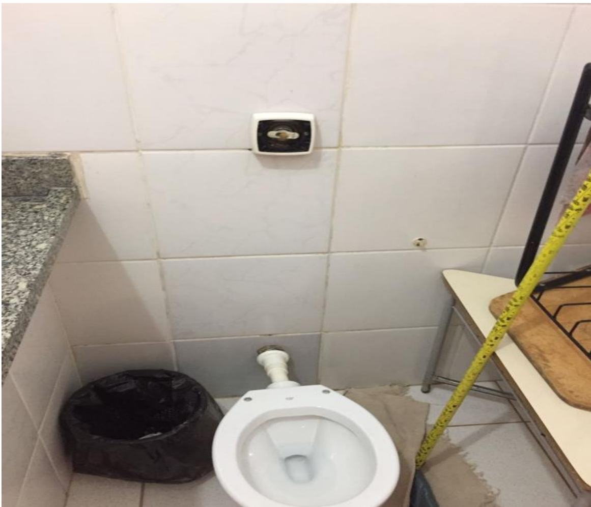
Figura 4 – Válvula de descarga com problemas no banheiro do Berçário II
