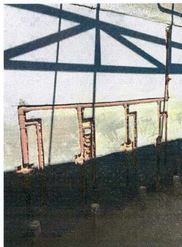
Foto 2: Prumada de rede hidráulica e rede de esgoto.
