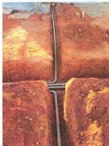
Fotos 4: Rede hidráulica.
