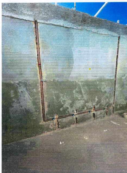
Foto 1: Prumada de rede hidráulica.
