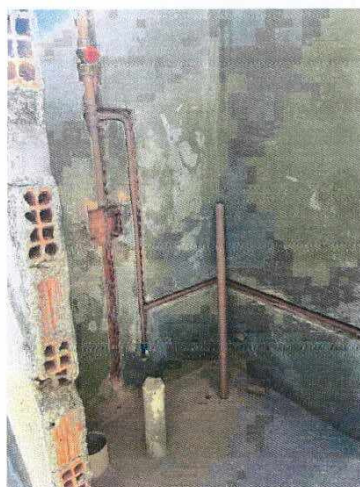
Foto 3: Prumada de rede hidráulica e rede de esgoto.
