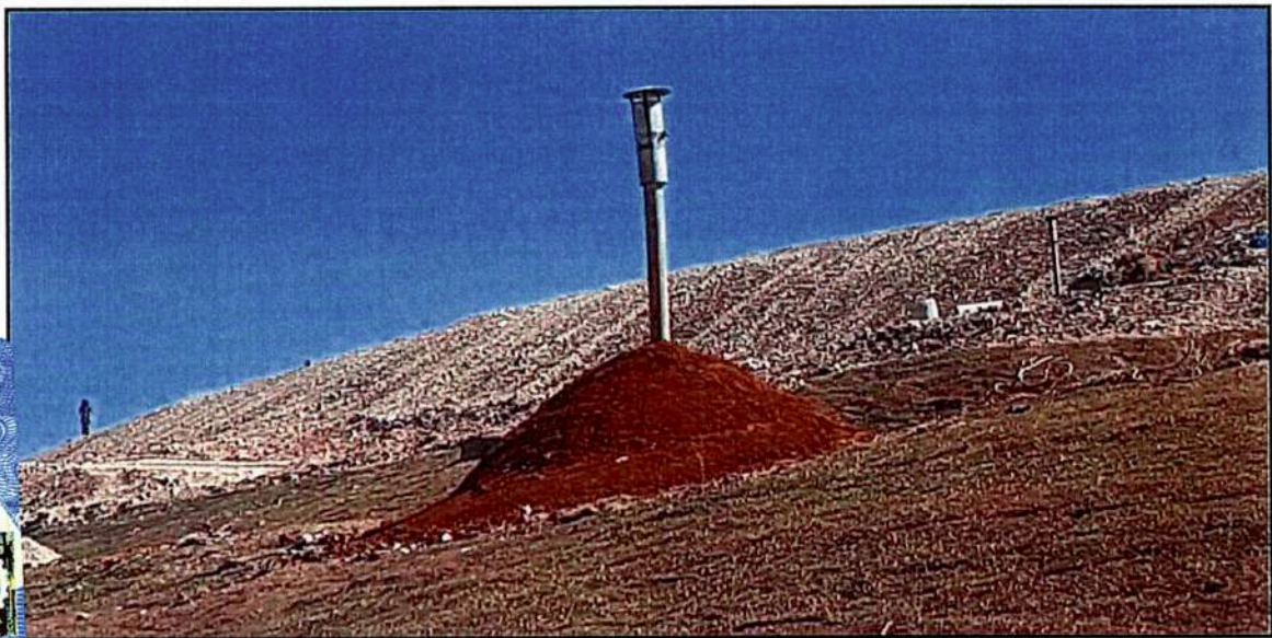
Figura 03: Dispositivo de queima do biogás (Flare) do ASB (Samambaia-DF).
