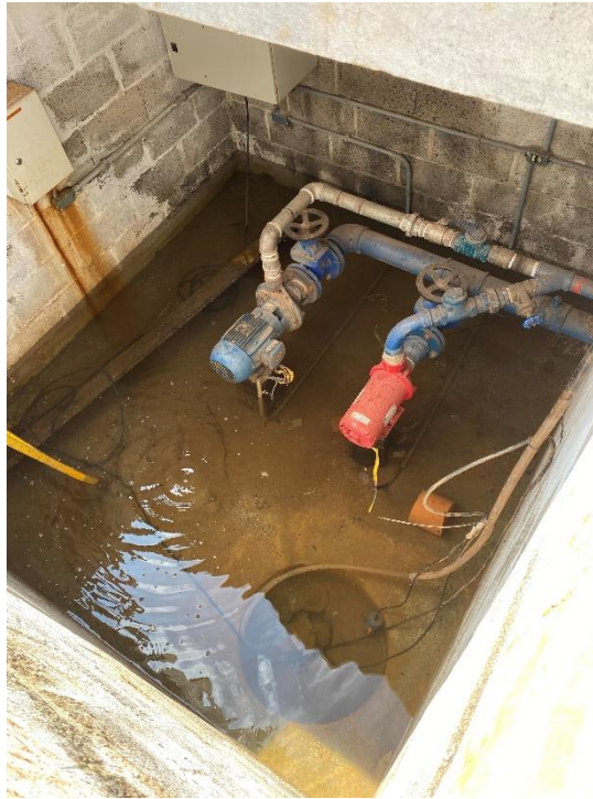
Figura 46 – Bombas CR Três Cruzes (Sistema Sede)
