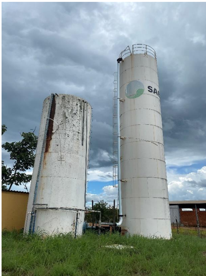
Figura 76 – RAP 1 e 2 Casa de química (Sistema de Santo Antônio do Rio Verde)
