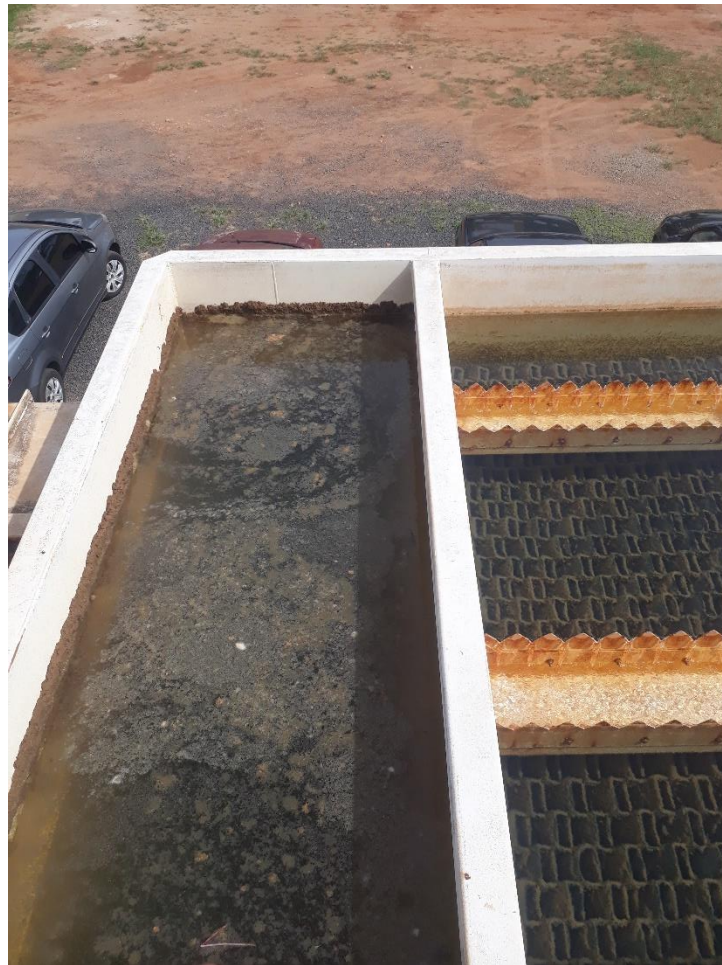
Figura 32 – ETA compacta I (Sistema Sede)
