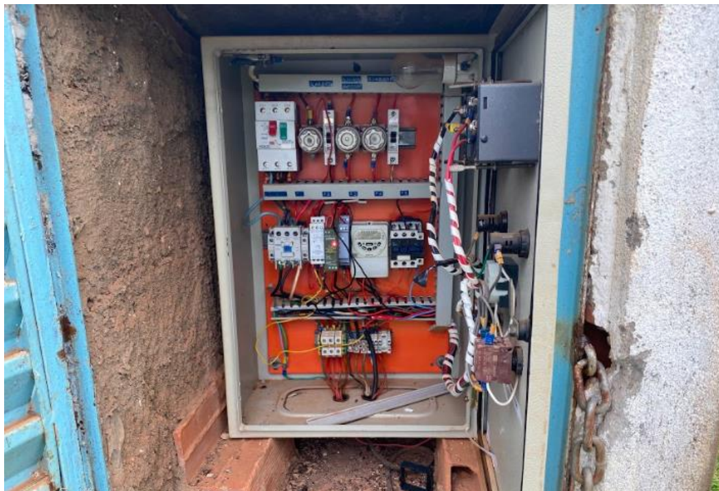
Figura 72 – Quadro de comando Poço da Cidade (Sistema Santo Antônio do Rio Verde)
