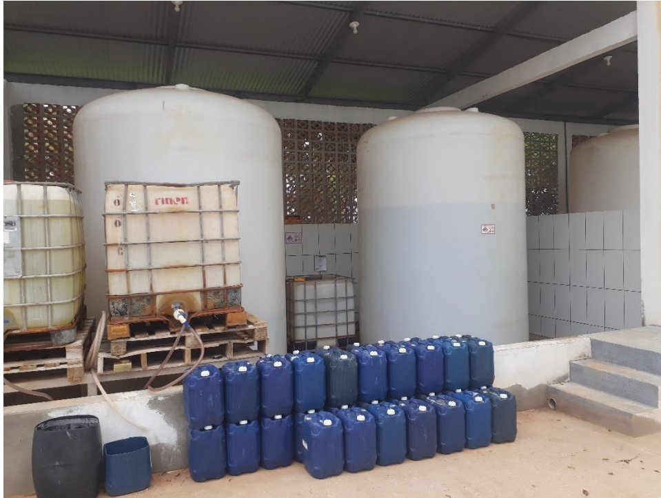
Figura 31 – Tanques de armazenamento de insumos
