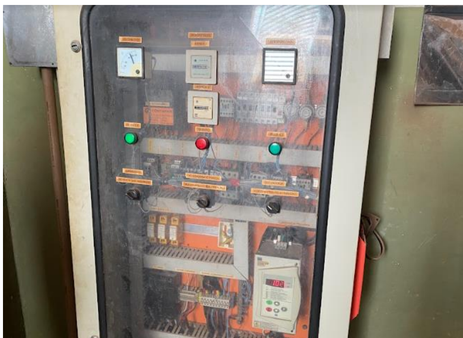
Figura 51 – Quadro de comando EEAT Ipanema (Sistema Sede)
