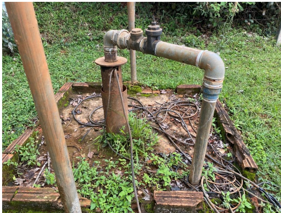
Figura 61 – Poço do Manga (Sistema Santo Antônio do Rio Verde)
