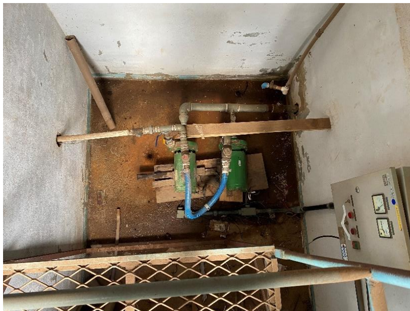
Figura 58 – Conjuntos motobomba (Pires Belo)
