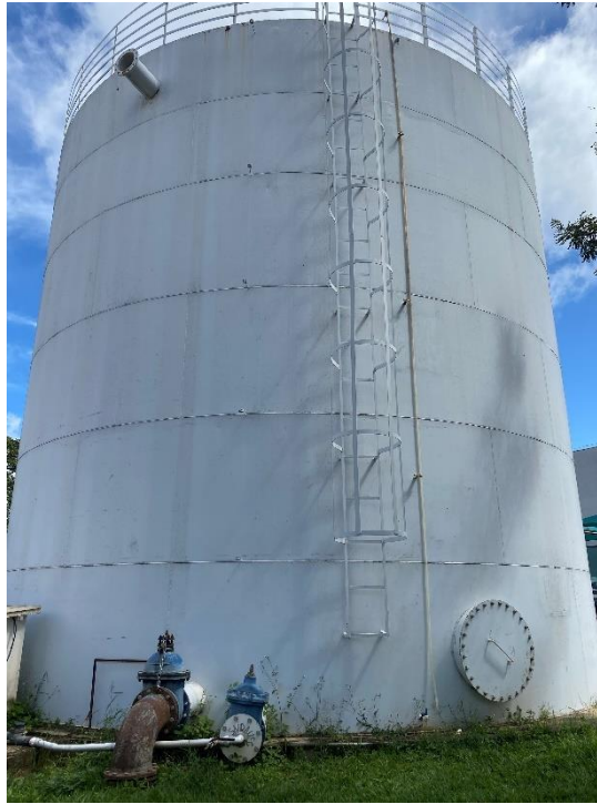
Figura 45 – Reservatório da UFG (Sistema Sede)
