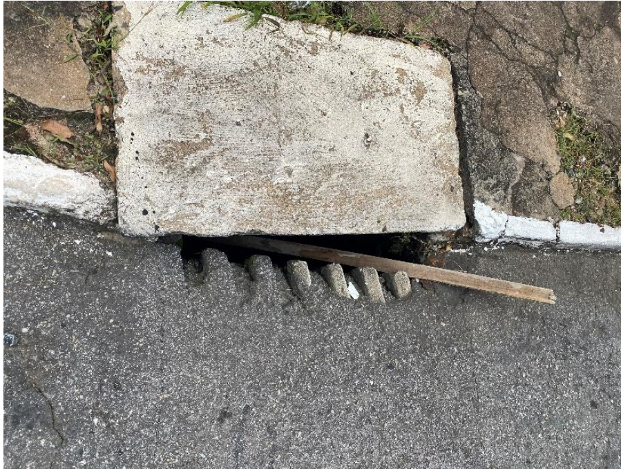
Figura 126 – Boca de lobo obstruída
