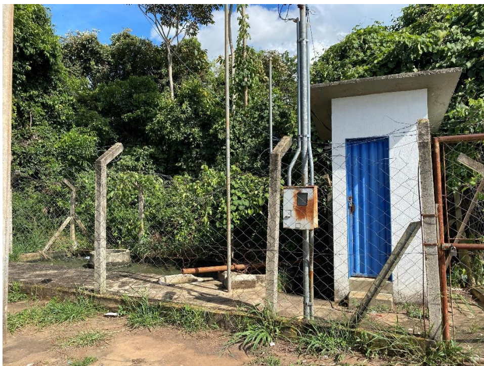
Figura 93 – Elevatória Cidade Jardim (Sistema Sede)
