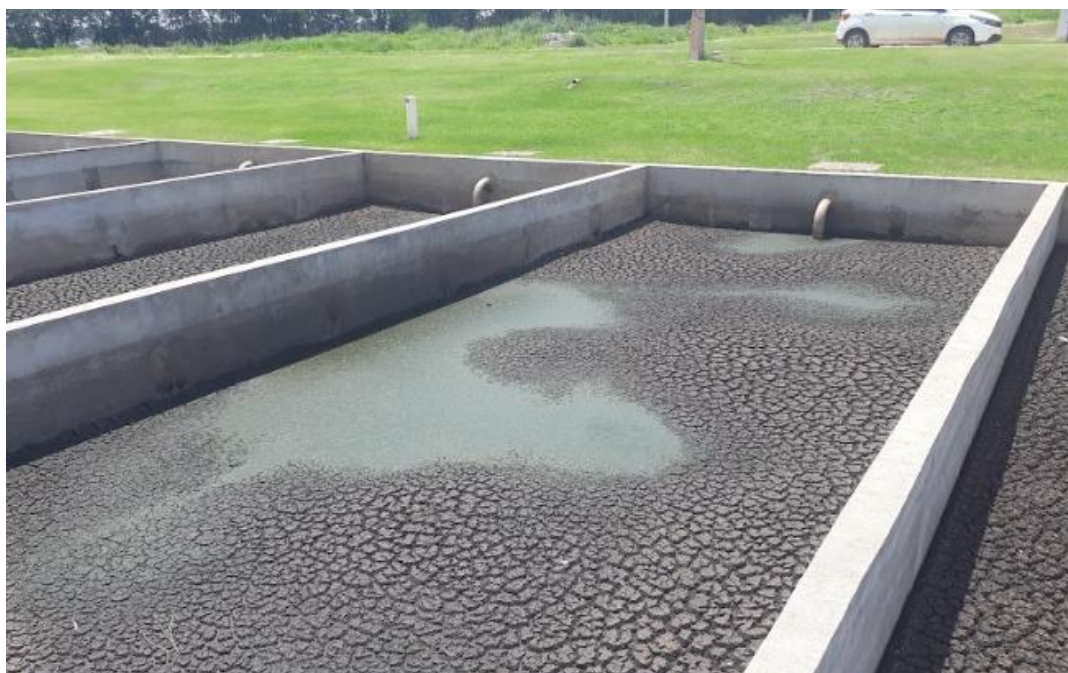
Figura 103 – Leitos de secagem ETE Catalão (Sistema Sede)
