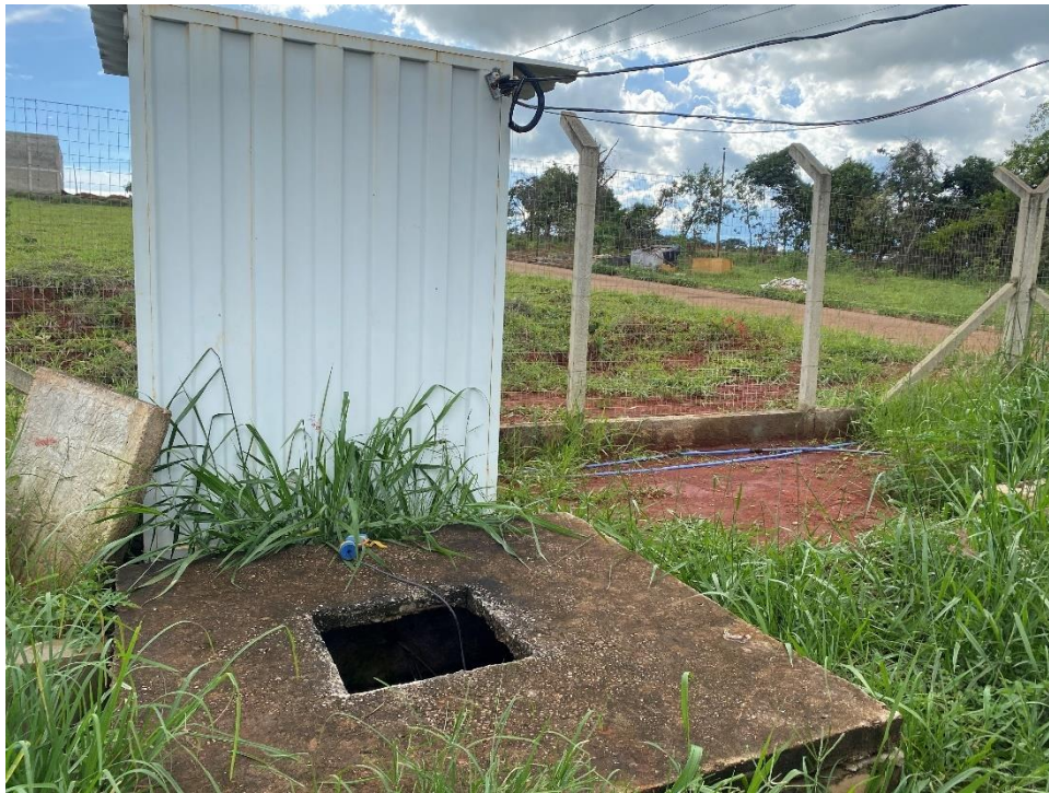
Figura 98 – Elevatória Copacabana II (Sistema Sede)
