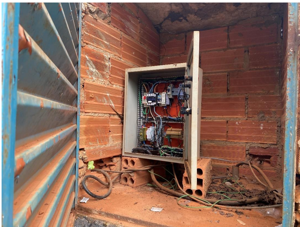
Figura 62 – Quadro de comando Poço do Manga (Sistema Santo Antônio do Rio Verde)
