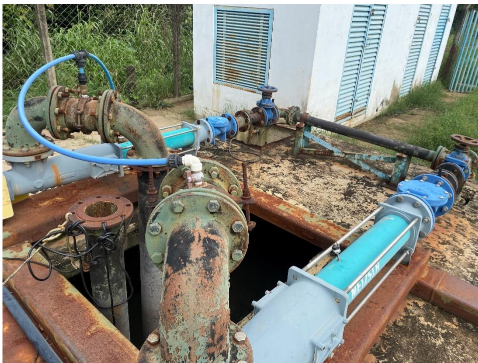
Figura 88 – Elevatória Leblon (Sistema Sede)
