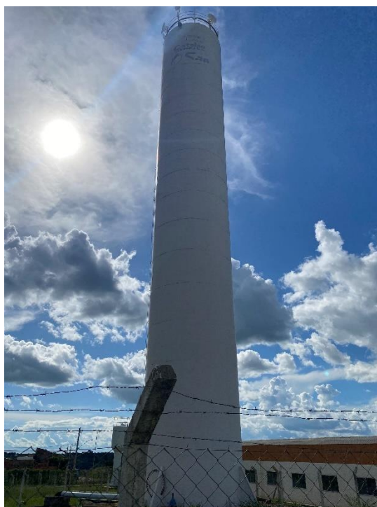
Figura 38 – Reservatório da Conquista (Sistema Sede)
