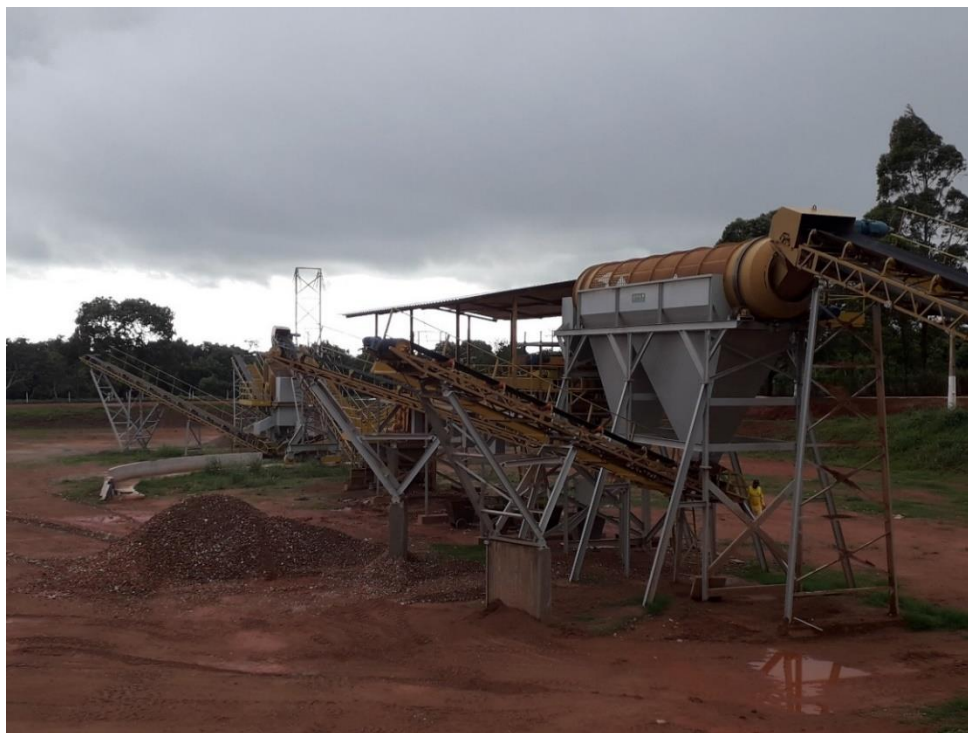
Figura 120 – Usina de reciclagem de resíduos de construção civil
