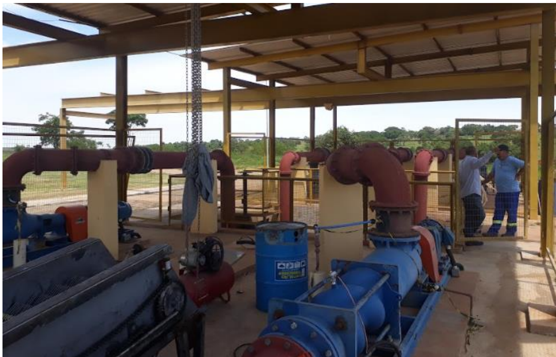
Figura 101 – Conjuntos motobomba ETE Catalão (Sistema Sede)
