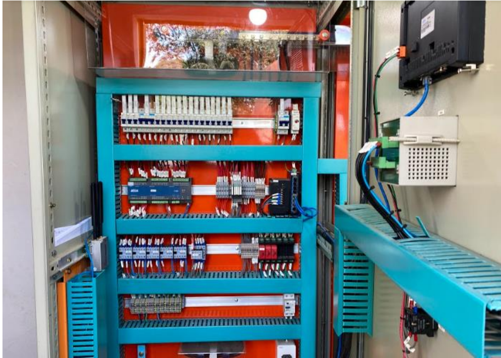
Figura 87 – Quadro de comando EEE Maria Amélia II (Sistema Sede)
