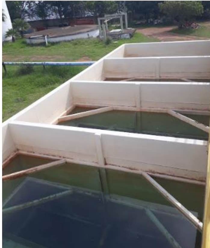
Figura 33 – ETA compacta II (Sistema Sede)
