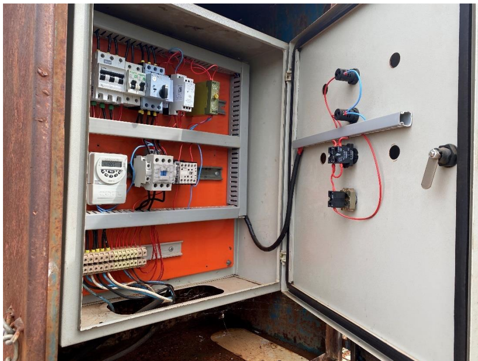
Figura 70 – Quadro de comando Poço do Gato (Sistema Santo Antônio do Rio Verde)
