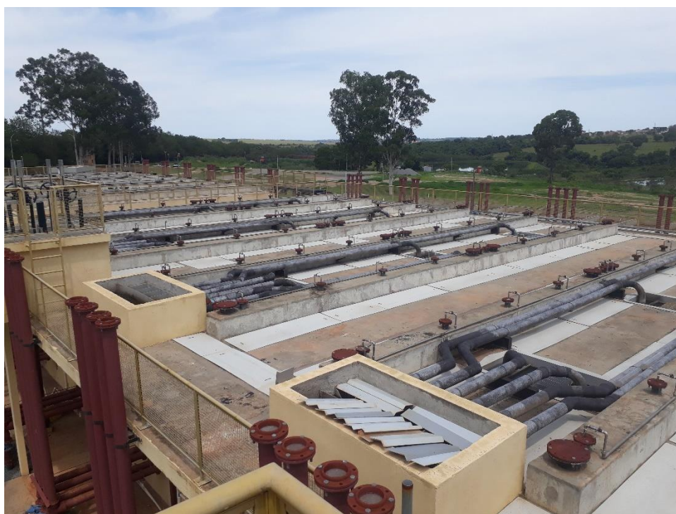
Figura 100 – Reatores anaeróbios ETE Catalão (Sistema Sede)
