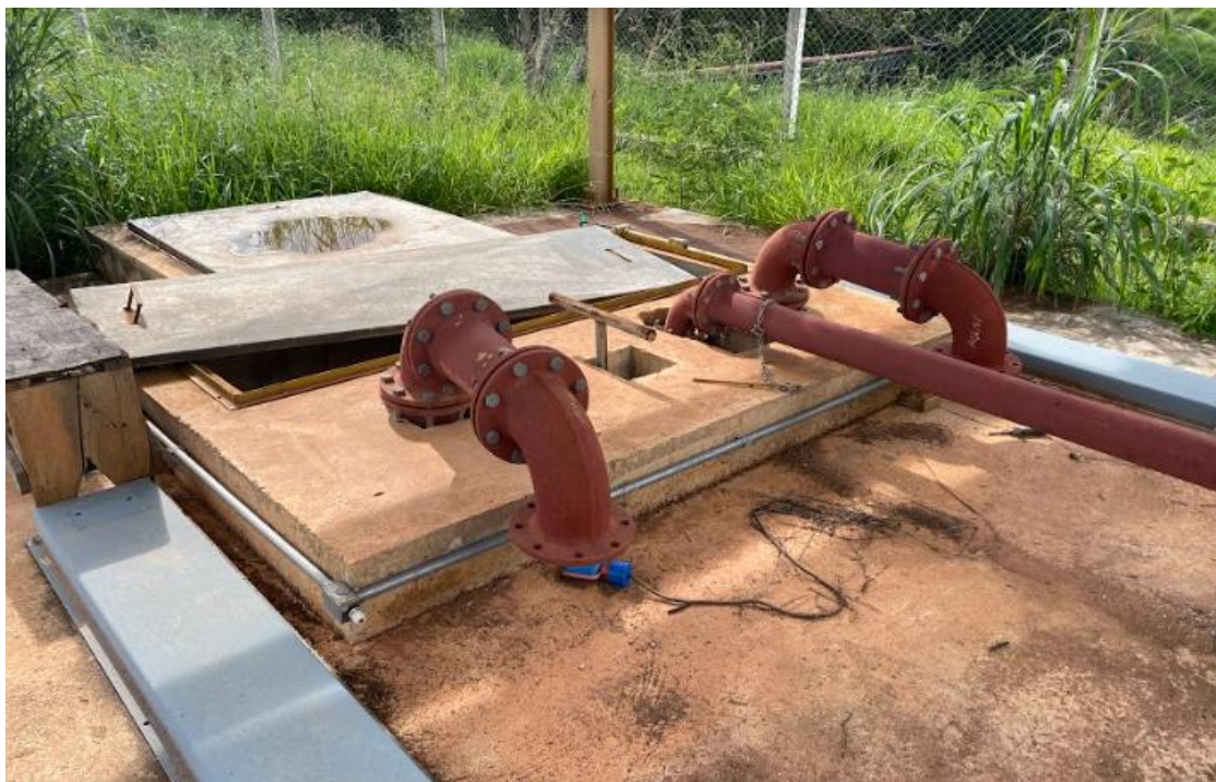
Figura 96 – Elevatória Ayrton Senna (Sistema Sede)
