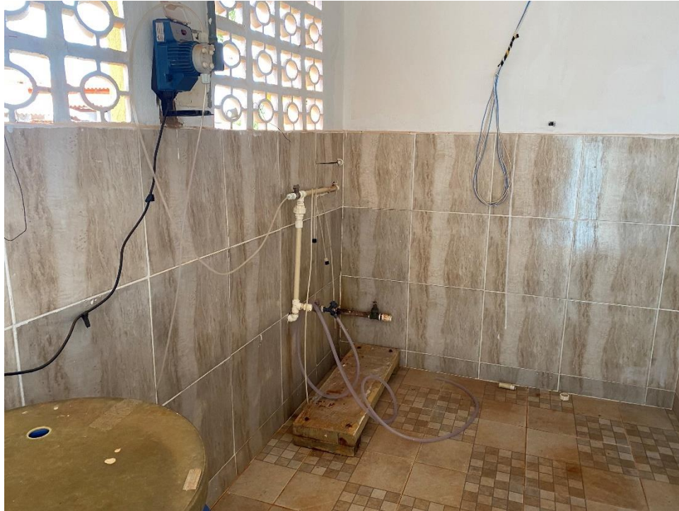
Figura 75 – Casa de química (Sistema Santo Antônio do Rio Verde)
