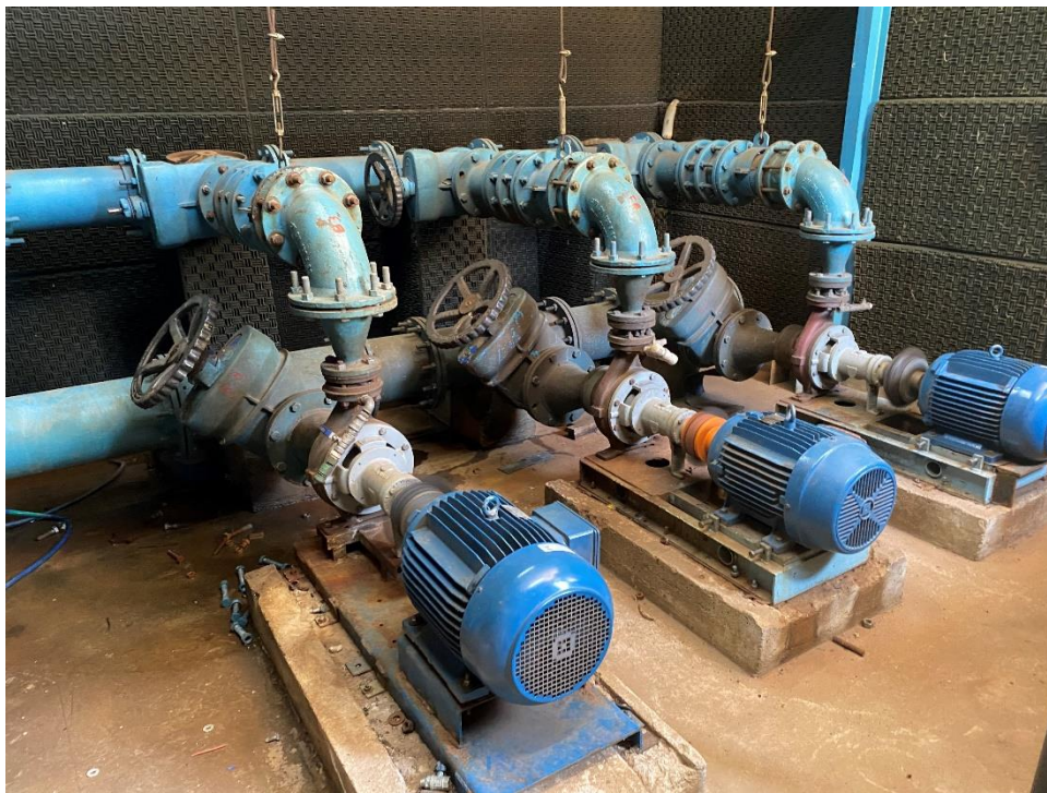
Figura 48 – EEAT Santo Antônio (Sistema Sede)
