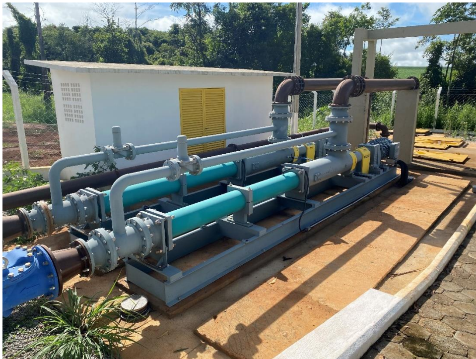
Figura 86 – Elevatória Maria Amélia II (Sistema Sede)
