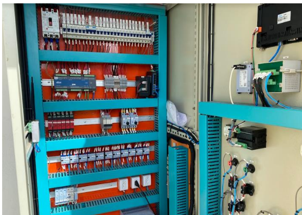
Figura 81 – Quadro de comando EEE Alvino Albino I (Sistema Sede)
