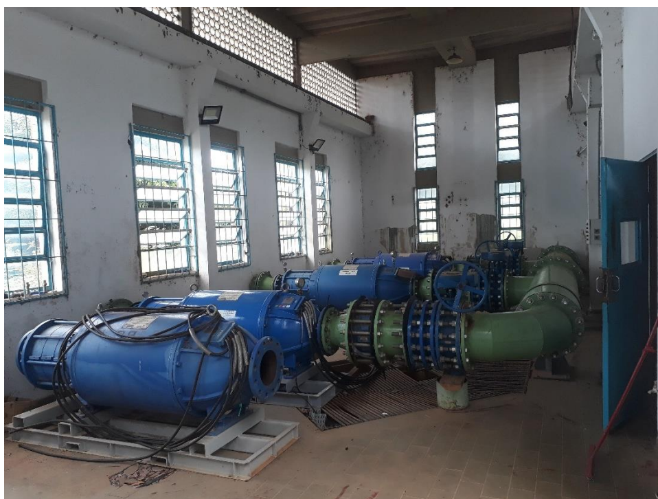
Figura 28 – Conjunto motobomba EEAB 2
