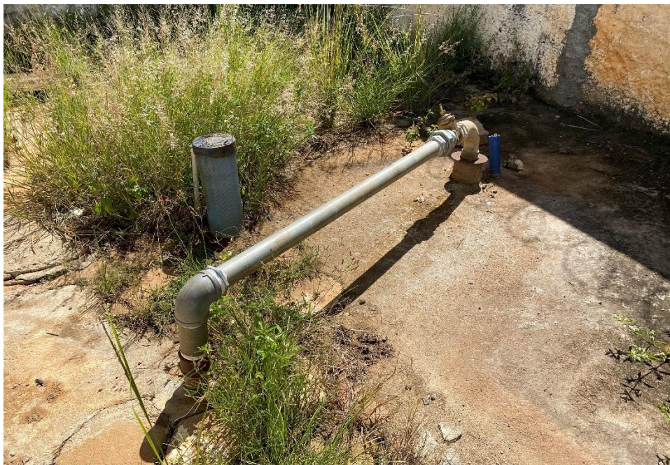
Figura 23 – Poço ETA Sto Antônio (Sistema Sede)
