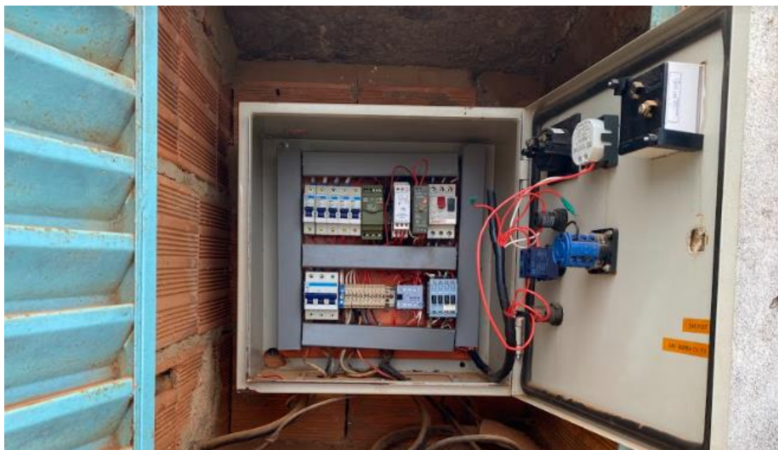
Figura 66 – Quadro de comando Poço do Piqui (Sistema Santo Antônio do Rio Verde)
