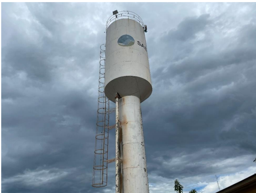
Figura 77 – REL Casa de química (Sistema de Santo Antônio do Rio Verde)
