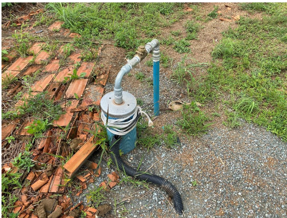
Figura 63 – Poço da Caixa d'água (Sistema Santo Antônio do Rio Verde)
