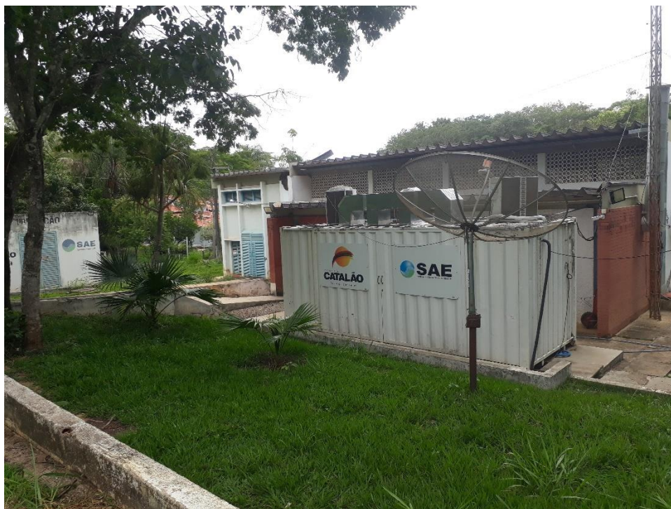
Figura 27 – EEAB 2 (Sistema Sede)
