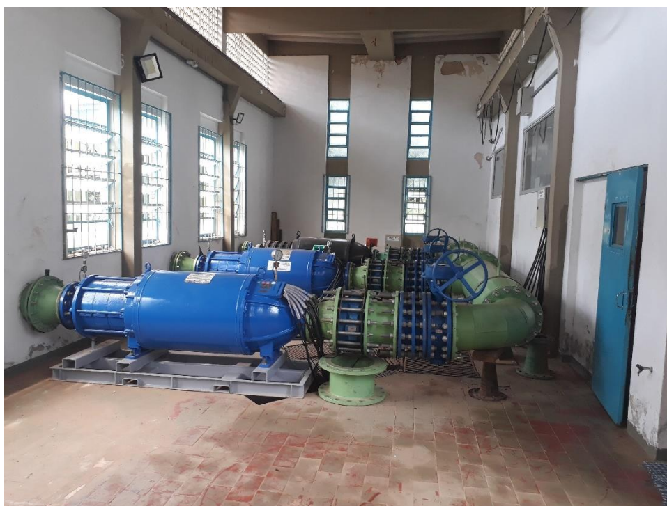
Figura 26 – Conjuntos motobomba da EEAB 1
