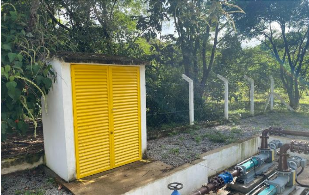
Figura 83 – Casa de comando EEE Alvino Albino II (Sistema Sede)
