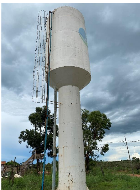
Figura 78 – REL Vilinha (Sistema de Santo Antônio do Rio Verde)
