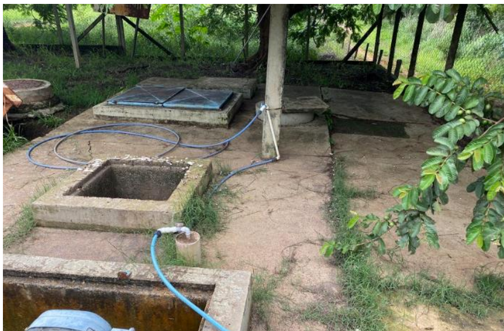
Figura 89 – Tanque de acumulação EEE Leblon (Sistema Sede)
