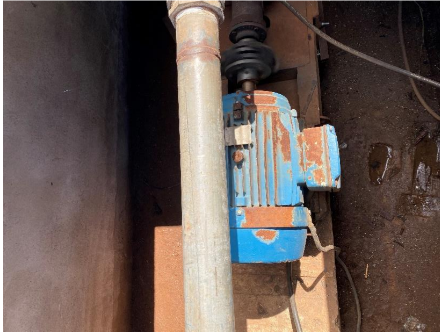
Figura 54 – Bomba do Booster rodoshopping (Sistema Sede)
