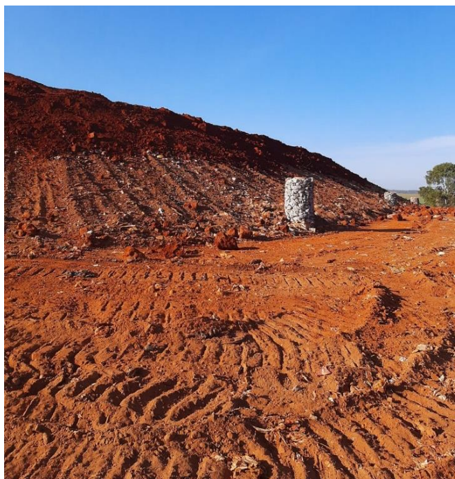
Figura 110 – Chaminés para coleta de gases
