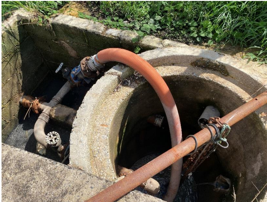
Figura 92 – Elevatória Jardim das Acácias (Sistema Sede)
