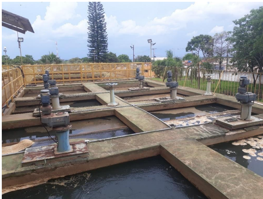
Figura 29 – Flocladores mecânicos ETA convencional (Sistema Sede)
