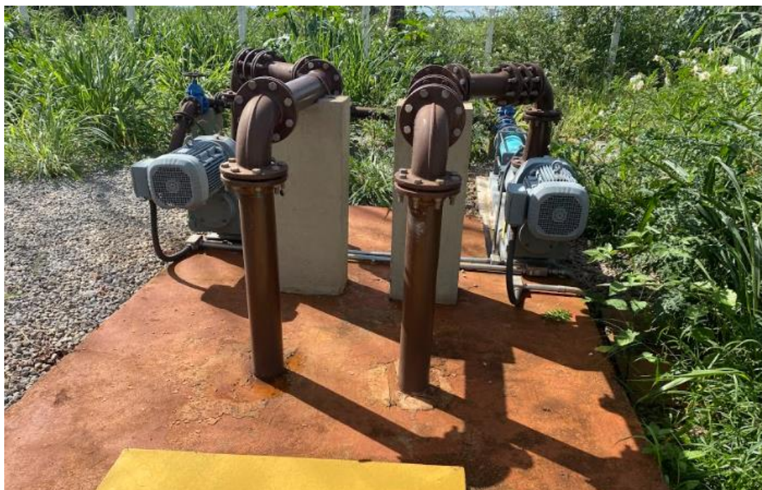
Figura 84 – Elevatória Maria Amélia I (Sistema Sede)
