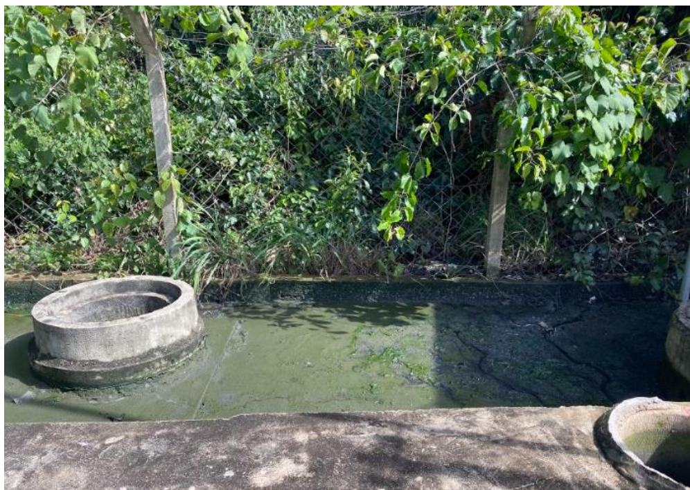
Figura 94 – Transbordamento EEE Cidade Jardim (Sistema Sede)
