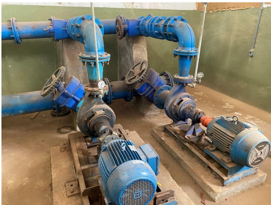
Figura 50 – EEAT Ipanema (Sistema Sede)
