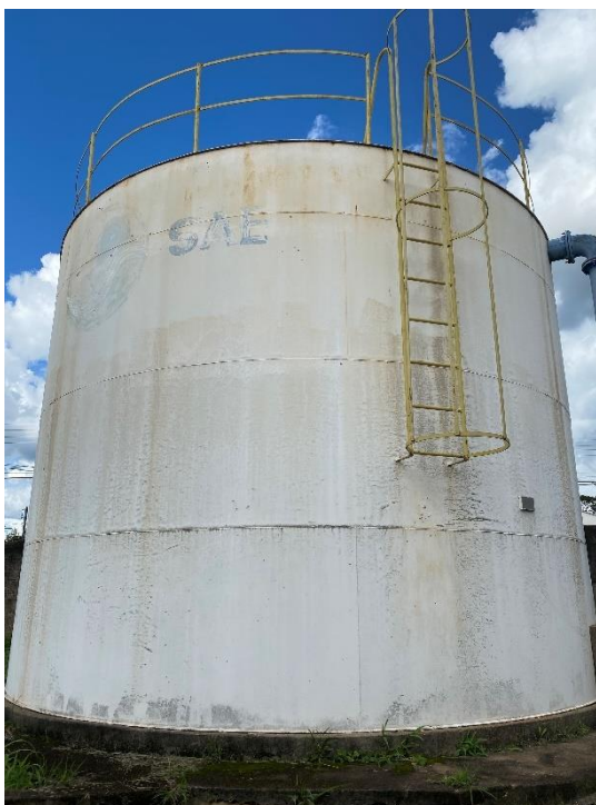
Figura 41 – Reservatório do bairro Ipanema (Sistema Sede)
