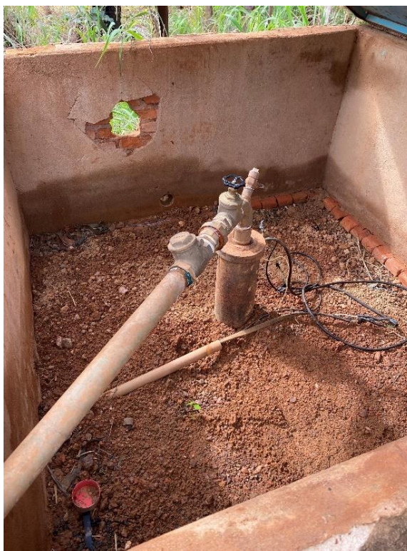
Figura 65 – Poço do Piqui (Sistema Santo Antônio do Rio Verde)
