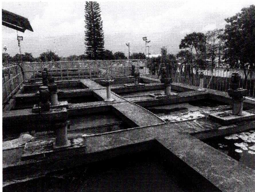
Figura 29 – Floculadores mecânicos ETA convencional (Sistema Sede)
