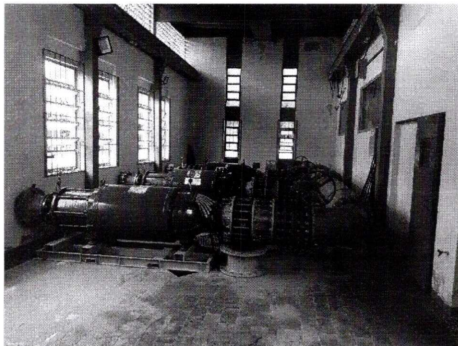
Figura 26 – Conjuntos motobomba da EEAB 1
