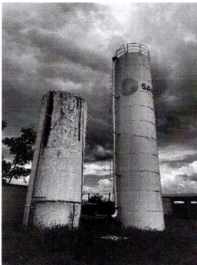
Figura 76 – RAP 1 e 2 Casa de química (Sistema de Santo Antônio do Rio Verde)
