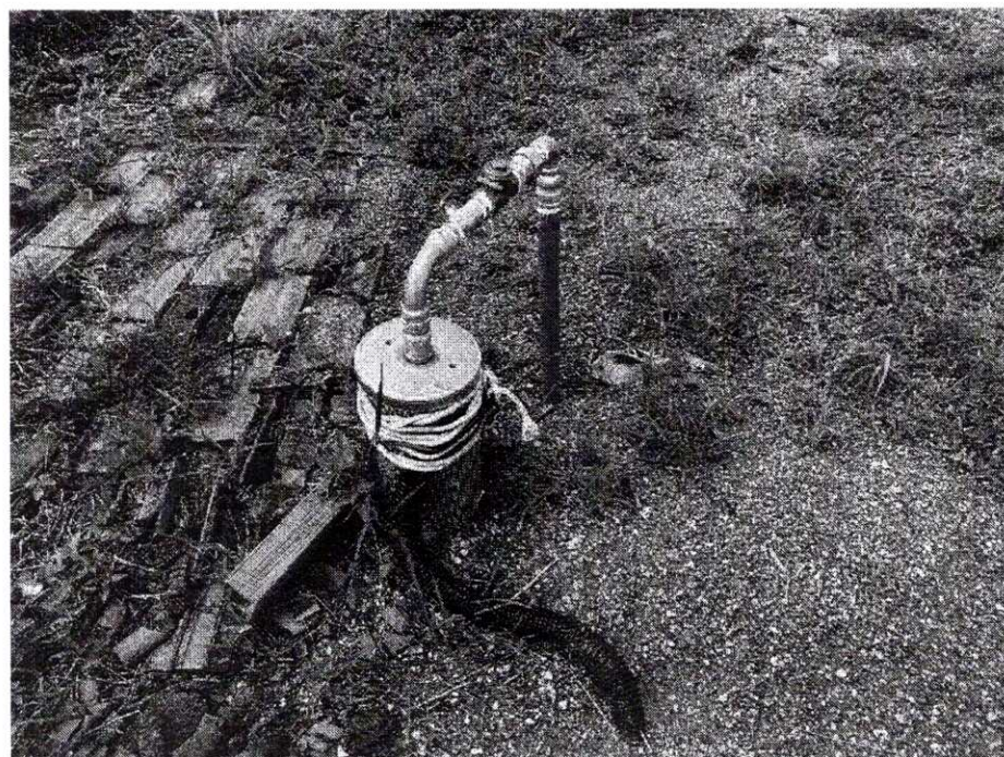
Figura 63 – Poço da Caixa d'água (Sistema Santo Antônio do Rio Verde)
