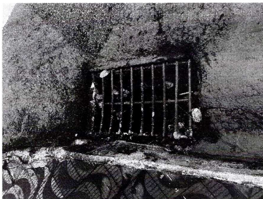
Figura 125 – Presença de resíduos sólidos urbanos em boca de lobo
