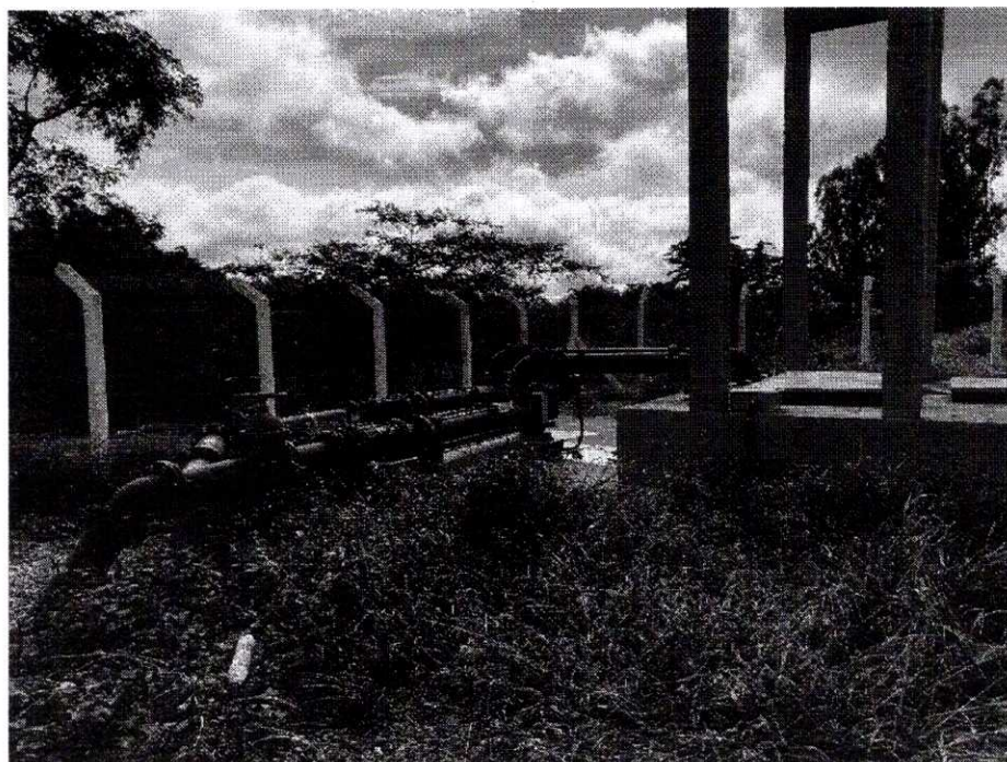
Figura 80 – Elevatória Alvino Albino (Sistema Sede)
