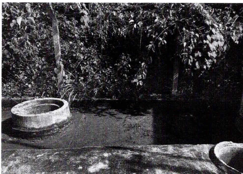
Figura 94 – Transbordamento EEE Cidade Jardim (Sistema Sede)
