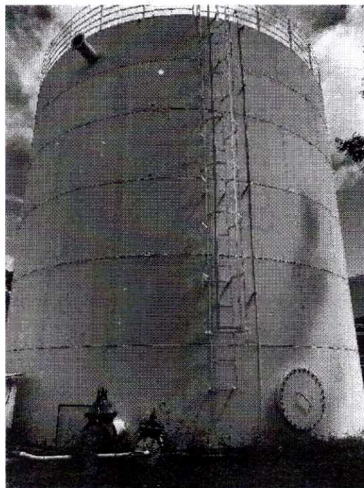
Figura 45 – Reservatório da UFG (Sistema Sede)
