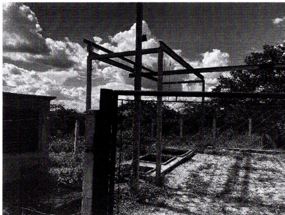
Figura 95 – Elevatória Conquista (Sistema Sede)
