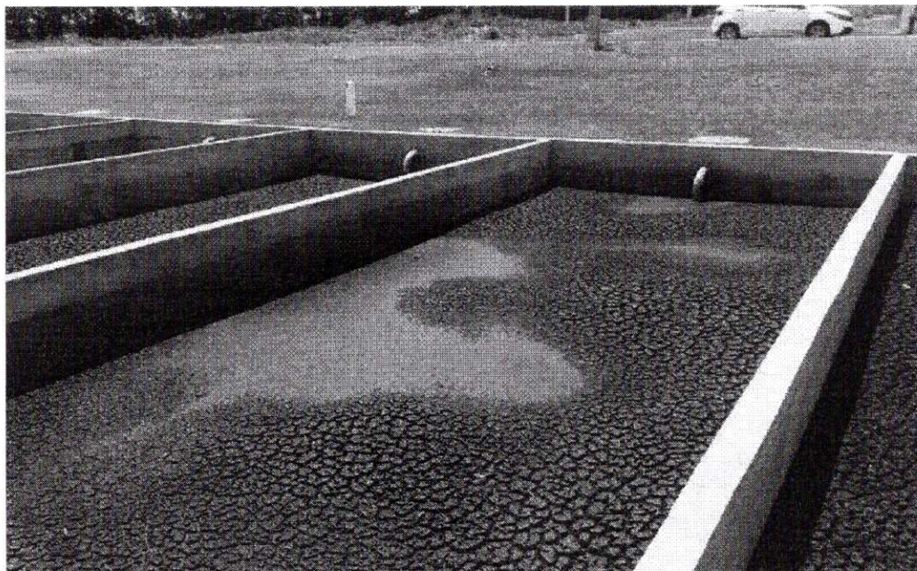
Figura 103 – Leitos de secagem ETE Catalão (Sistema Sede)
