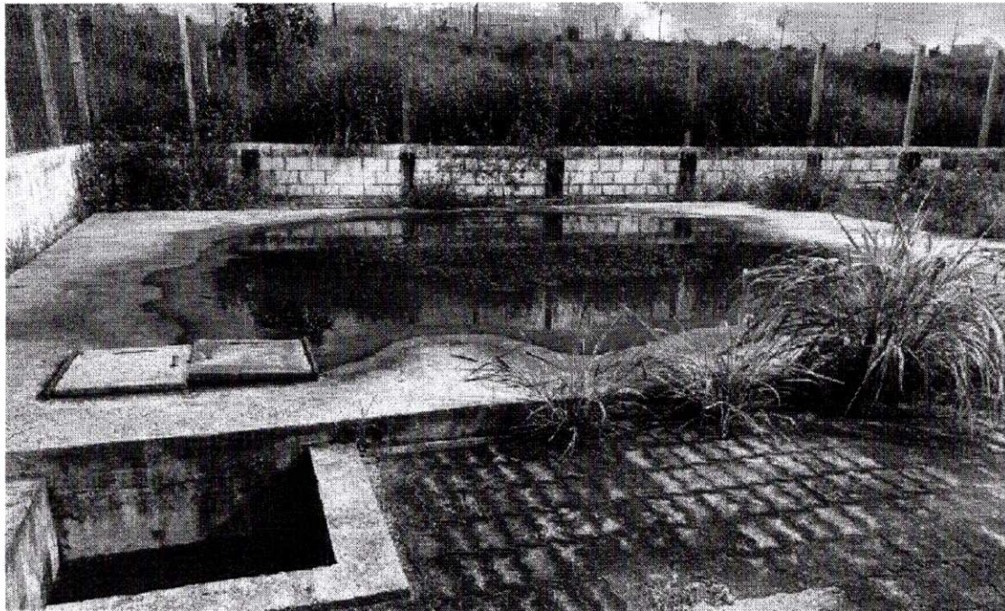
Figura 97 – Tanque de acumulação EEE Ayrton Senna (Sistema Sede)
