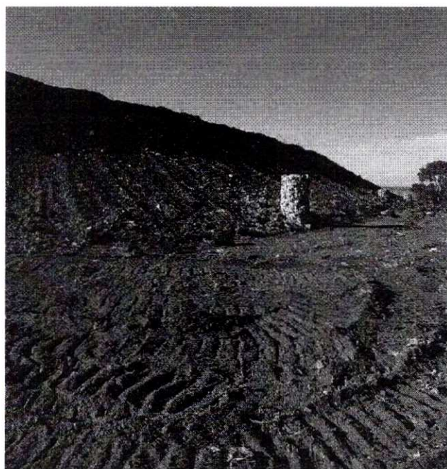
Figura 110 – Chaminés para coleta de gases
