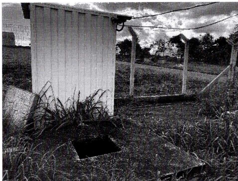
Figura 98 – Elevatória Copacabana II (Sistema Sede)
