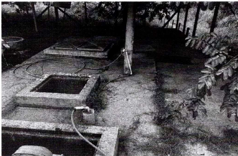
Figura 89 – Tanque de acumulação EEE Leblon (Sistema Sede)
