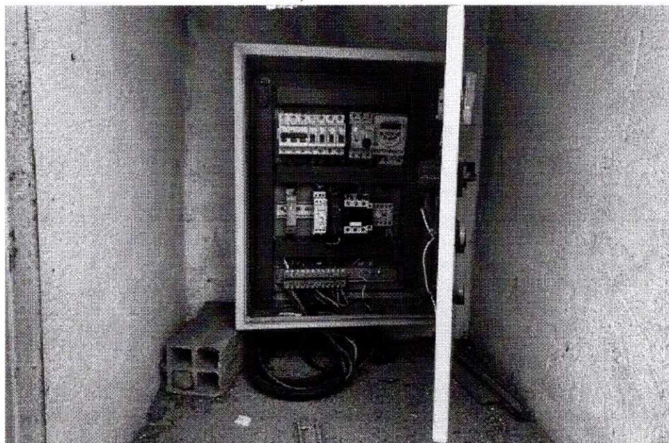
Figura 68 – Quadro de comando Poço do Carrapato (Sistema Santo Antônio do Rio Verde)
