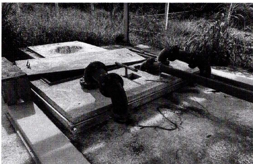
Figura 96 – Elevatória Ayrton Senna (Sistema Sede)
